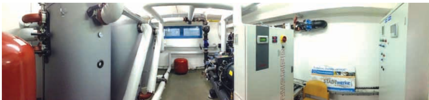
Рисунок 2. Тепловой насос компании STADTwerke Amstetten использует теплоту канализационных стоков, поступающих из расположенного рядом канализационного коллектора (на фото справа) и три емкости объемом 1,5 м 3 для сбора сточных вод (слева)
