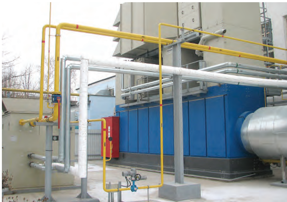
ОАО «Минский комбинат силикатных изделий», ГТУ «Turbomach» Centaur 40 GS мощностью 3,5 МВт. Экономия от комбинированной выработки ГТУ электрической и тепловой энергии в 2012 году составила 490 т у.т.
