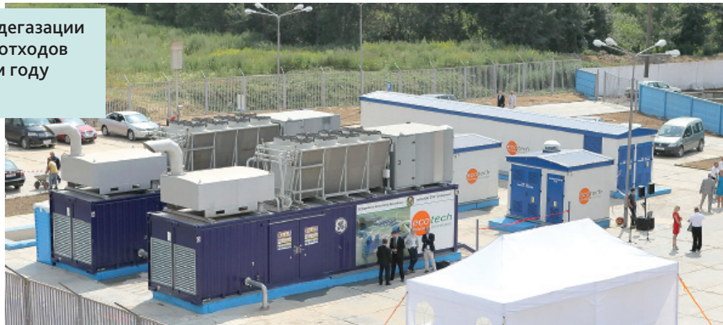
Установка по получению электроэнергии из свалочного газа на полигоне твердых бытовых отходов «Северный». Суммарная мощность проекта в ближайшем будущем достигнет 5,6 МВт
