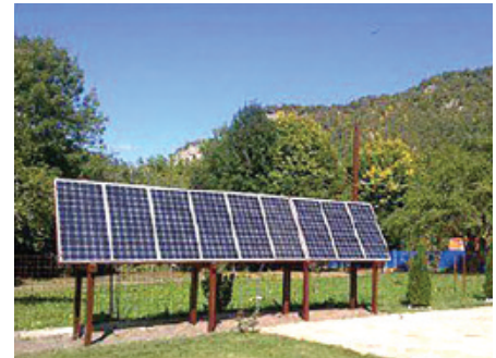
Рис. 5. Пример установки солнечных панелей
