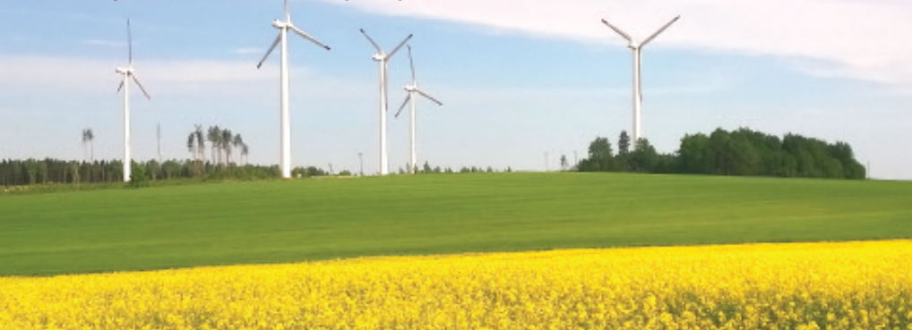
Ветроэлектростанция ООО «Газосиликат-Люк» в д. Пудовня Могилевского района, включающая в себя 8 ветроэнергоустановок общей мощностью 8 МВт, выработала за 9 месяцев текущего года 1971 кВт·ч электроэнергии
