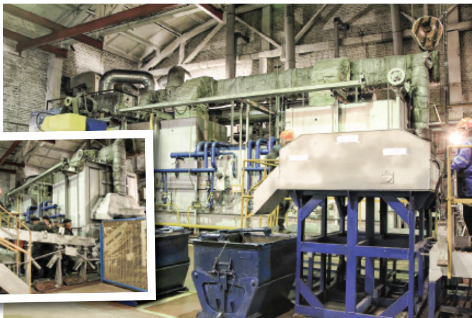
Внедрение установки для нагрева воды за счет утилизации тепла дымовых газов за печью нормализации в ЛЦ-1 РУП «Минский тракторный завод». Годовой экономический эффект 106,7 т у.т., или 22,9 тыс. $. Срок окупаемости менее месяца
