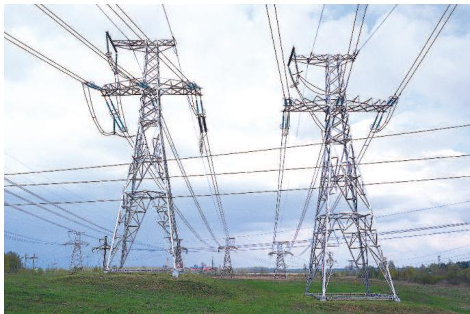
Выдача электроэнергии в сеть 330 кВ осуществляется по семи линиям электропередач и в сеть 110 кВ – по пяти ЛЭП
