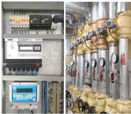
Технический учет тепловой энергии (пар, сетевая вода) – 12 точек учета
