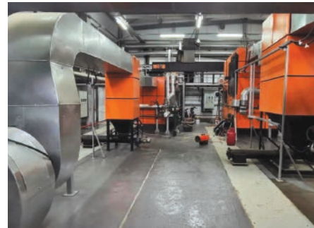
◆ Котельная в аг. Овсянка
