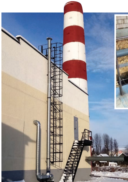
◆ Котельная «Центральная» ГП «Коханово-ЖКХ» мощностью 3,3 МВт (два котла). Введена в эксплуатацию 30 декабря 2022 года
