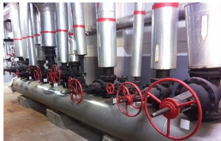
◆ Машинный зал котельной
