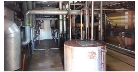
◆ Индивидуальный тепловой пункт цеха по производству сыров
