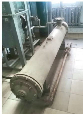
◆ Теплообменник подогрева питательной воды теплом непрерывной продувки
