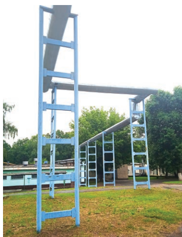
◆ Котельная и тепловые сети филиала ОАО «Гомсельмаш» санаторий «Машиностроитель»
