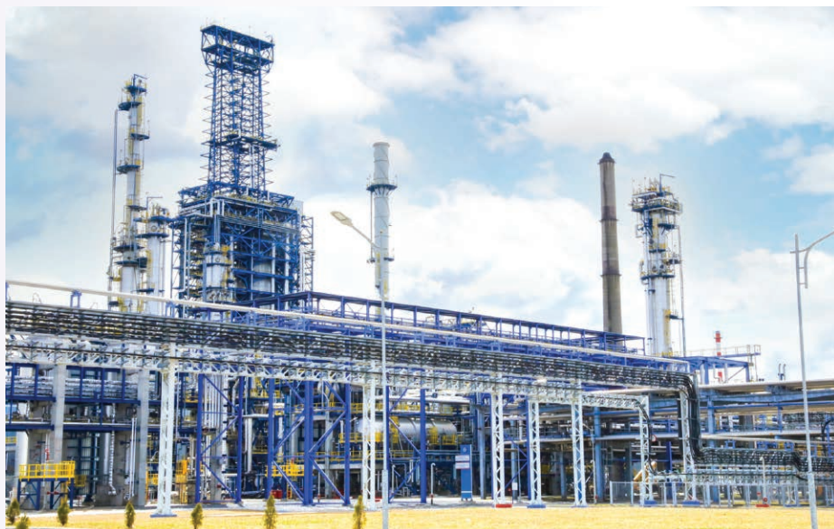
◆ ОАО «Нафтан»: установка замедленного коксования
