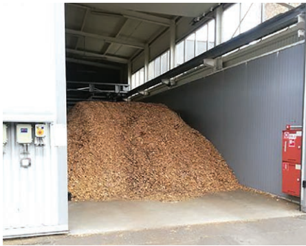
◆ Рис. 3. УП «Минскомунтеплосеть», котельная по адресу г. Минск, ул. Лынькова, 123
