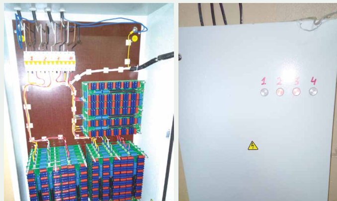
Устройство индивидуальной компенсации реактивной мощности компрессорного оборудования мельницы сортового помола
