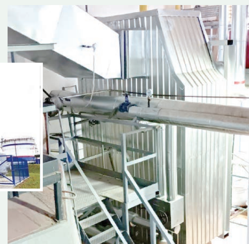
◆ Волковысское ОАО «Беллакт»: экономайзер парового котла ДЕ 16/24-ГМО
