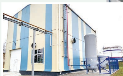
◆ ОАО «Лакокраска»: азотно-кислородная станция цеха №3 (воздухоразделительная установка)
