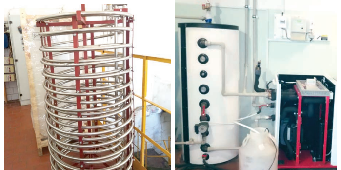
Рис.6. Вид на спиральный теплообменник и оборудование системы теплоснабжения посредством теплового насоса типа «рассол-вода»
