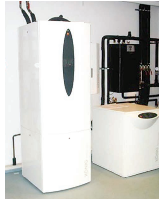
Рис.5. Вид на оборудование системы теплоснабжения посредством геотермального теплового насоса
