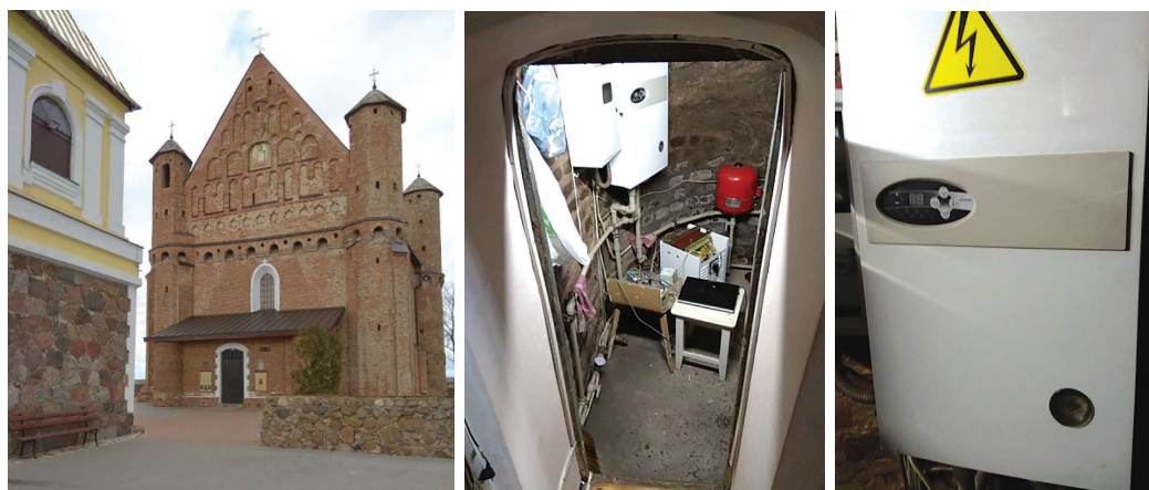
Рис. 8. Вид на здание и оборудование системы теплоснабжения посредством аэротермального теплового насоса
