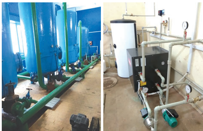
Рис. 7. Вид на оборудование водоочистки и системы теплоснабжения посредством гидротермального теплового насоса
