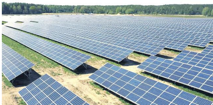
ФЭС «Чечевичи» ООО «ЭнергоСтройГрупп», 10,0 МВт, Быховский район, д. Чечевичи
