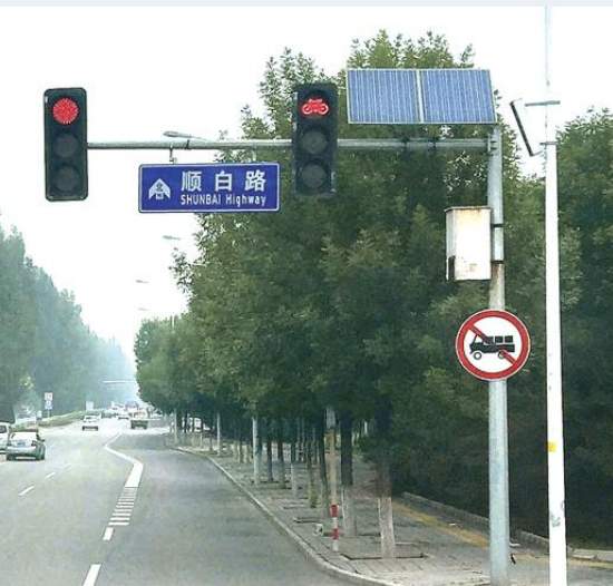
Светофоры с фотоэлектрическими панелями
